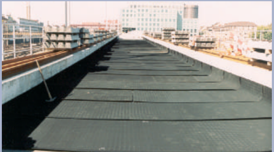
Figura 7: Esteras de vía permanente USM® sobre puente de concreto colocadas antes de la aplicación del balasto
